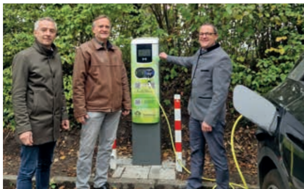
Bei der Abnahme der neuen Ladesäule (v.l.): Erster Bürgermeister Norbert Seidl, Zweiter Bürgermeister Dr. Manfred Sengl und KommEnergie-Geschäftsführer Matthias Morche
